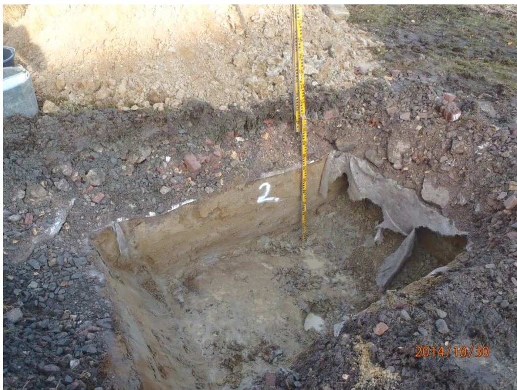
Bild 4.1 Pg 1402 påträffades rivningsrester och materialskiljande geotextil ovanför leran.
