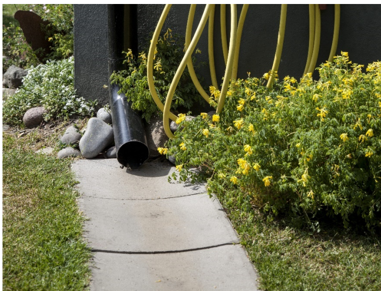
Figur 30. Exempel på stuprör med vattenutkastare och ränna (bild: VA SYD).
