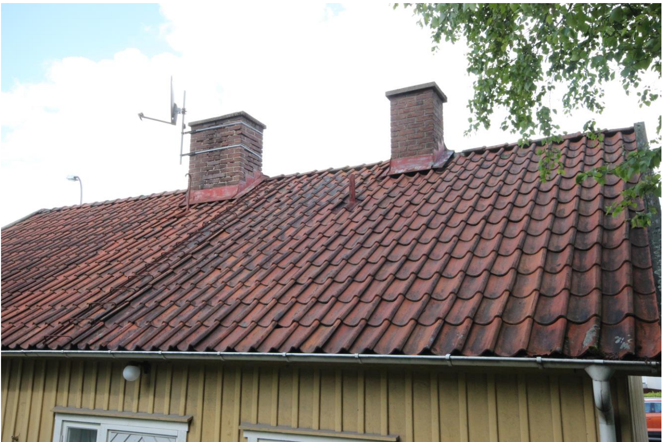
Sadeltaket är avtäckt med enkupigt lertegel. Västra murstocken revs under 1900-talet och ersattes då av en ny. Båda skorstenarna är av murat rött tegel.
