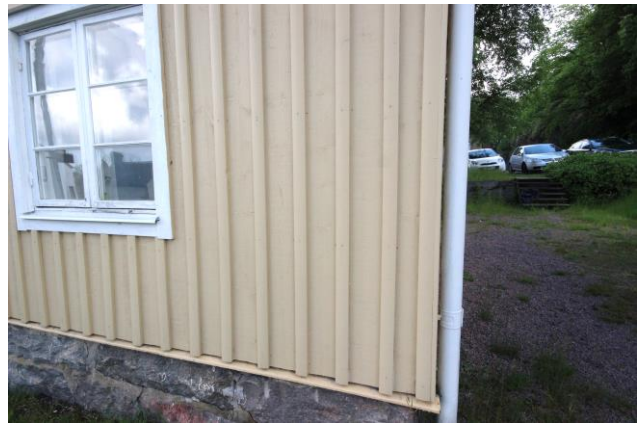
Panelen mot väster är möjligen spikad på en underliggande panel då den är placerad något längre ut än övrig panel.
